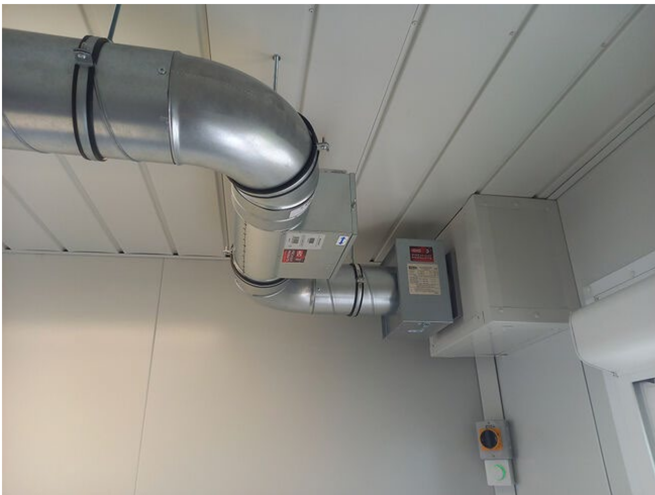
Le système de ventilation en partie haute se compose d'un ventilateur, d'un caisson filtrant et d'une batterie de chauffage. © Christian Robischon
